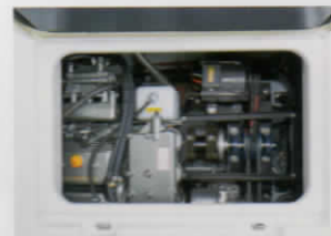
エンジンルーム出入口ハッチ[キャビン]
