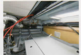
補機設置スペース
