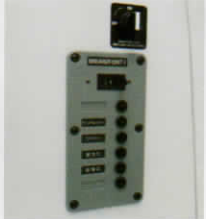
メインスイッチ(リレー式) / ブレーカーパネル
