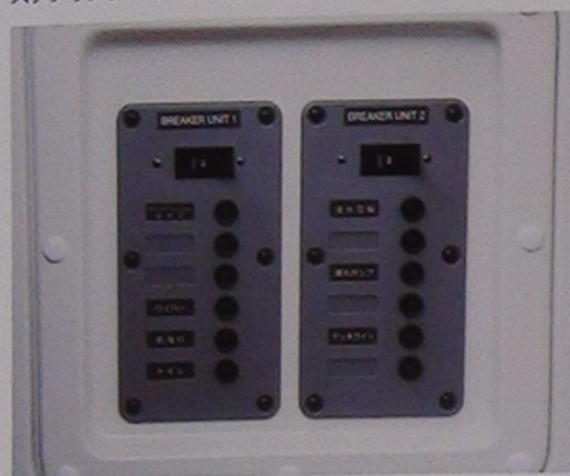
ブレーカーパネル
