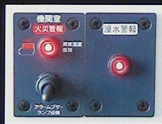
火災警報装置・浸水警報装置(OP)
