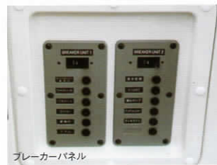
ブレーカーパネル
