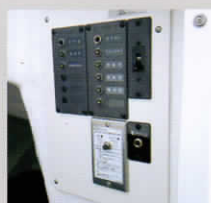
●ブレーカーパネル
