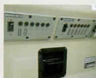
ブレーカーパネル
