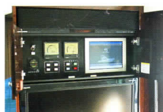
●配電盤&パワーマネジメントシステム(工場OP タッチパネル式)
